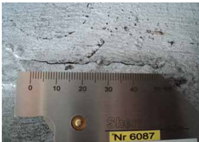
Fot. 1. Pęknięcie zmęczeniowe w sąsiedztwie zaspawanego otworu, w strefie przypodporowej dźwigara skrajnego. Zdjęcie wykonane w 2014 roku
