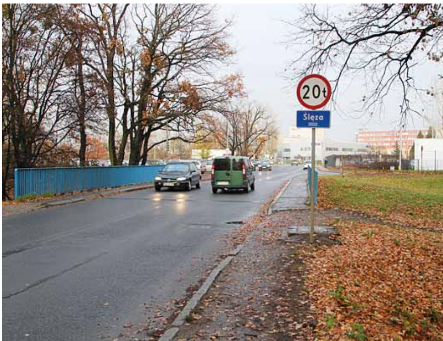
Fot. 4. Wjazd na most Muchoborski od strony ul. Krzemienieckiej. Widoczna jest mała szerokość chodników na obiekcie oraz brak utwardzonych chodników na dojazdach. Zdjęcie z grudnia 2015 roku
