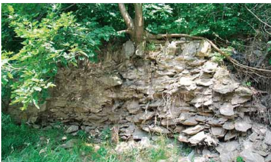
Rys. 5 Zupełnie zniszczony kamienny mur oporowy (stateczność gwarantowana przerostami korzeni drzew)
