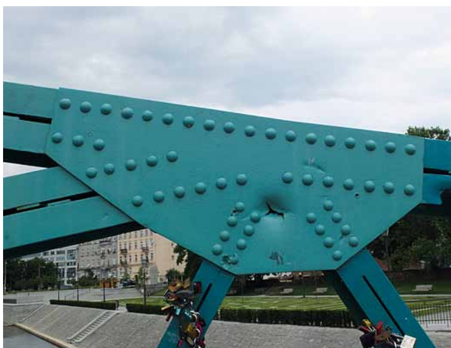
Rys. 4 Uszkodzenia blach węzłowych i profili walcowanych powstałe w wyniku działań wojennych 1939-1945
