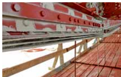
Rys. 9. Deformacje nakładek pasa dolnego spowodowane korozją i brakiem łączników
