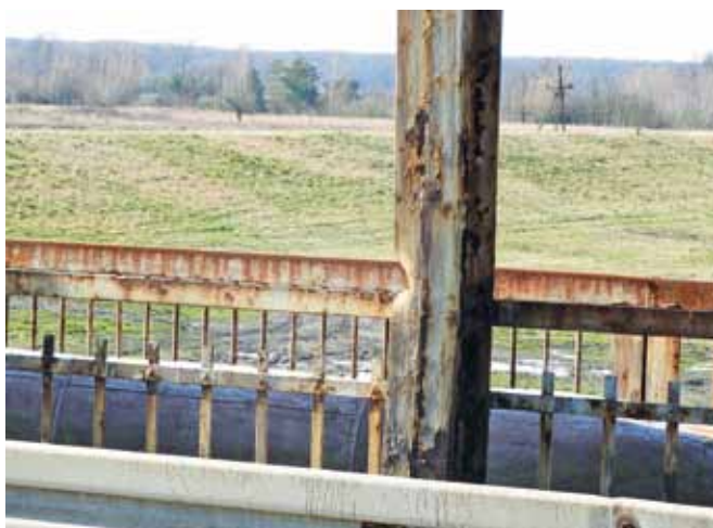
Rys. 6. Uszkodzenia wieżaków i słupków kratowych dźwigarów głównych
