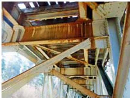
Fotografia 2. Widoczne nacieki korozyjne.
