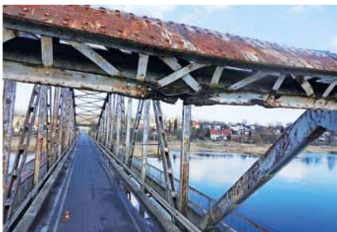
Rys. 7. Uszkodzenia tężników portalowych najdłuższego przęsła
