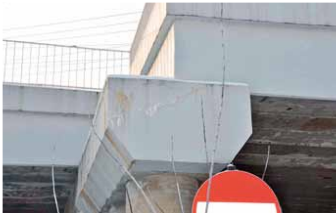
Fot. 1. Korozja oczepu podpory po kilku miesiącach od naprawy
