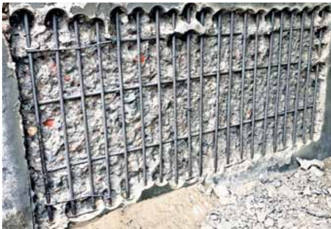
Fot. 4. Korozja zbrojenia
