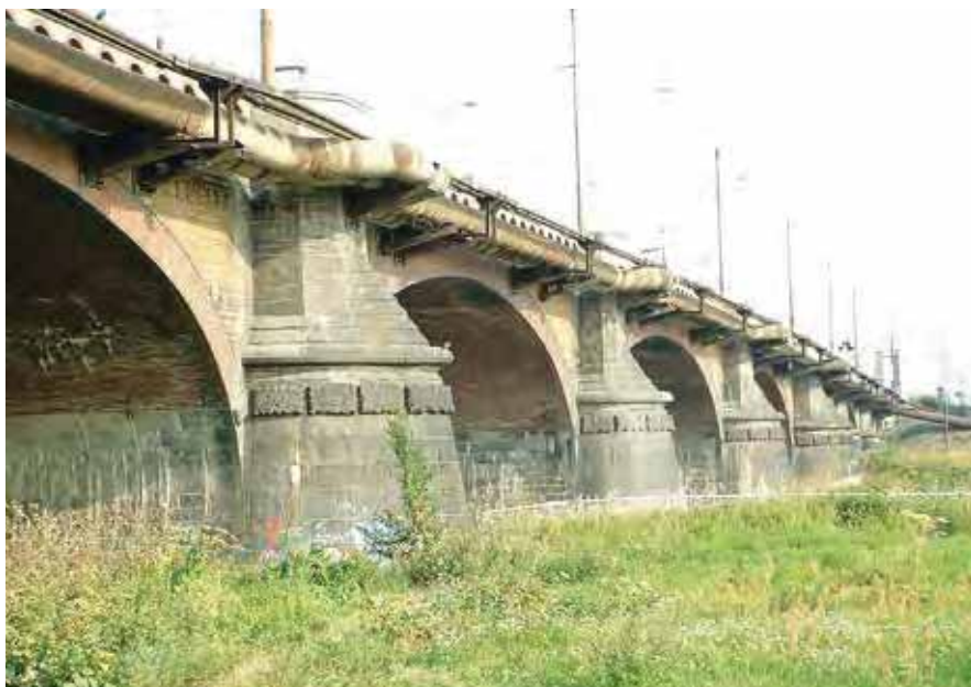
Rys. 9. Elewacja mostu Osobowickiego Północnego – stan współczesny z prowadzonymi po tarczy czołowej przewodami instalacji wodociągowych i kanalizacyjnych. Stan z 2007 roku. Fot. Leszek Budych.
