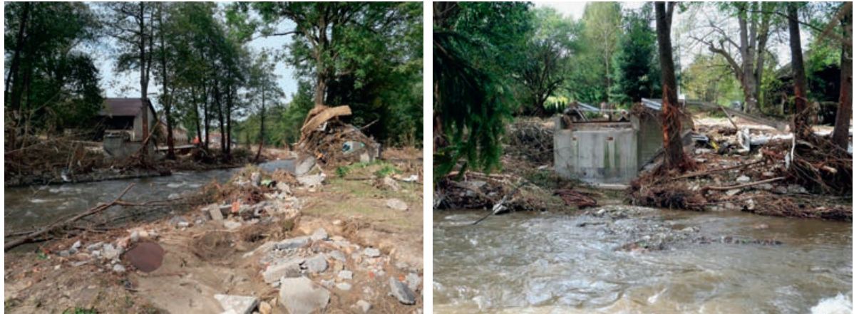
Fot. 5. Przyczółki stalowego mostu, całkowicie zniszczonego i zabranego przez wodę w Stojkowie (stan techniczny z 23 września 2024 r.)
