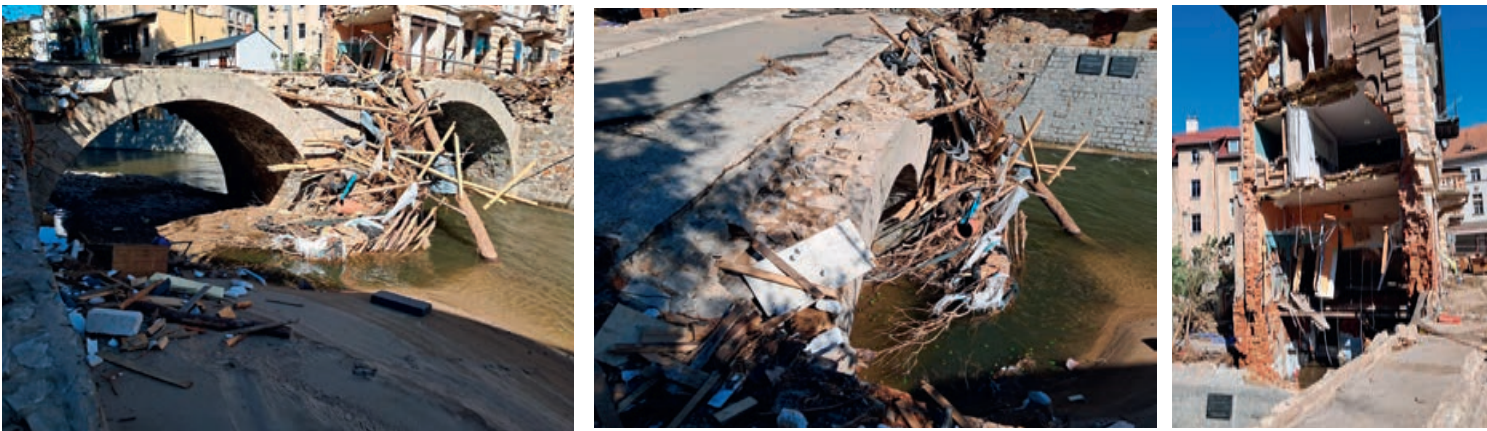
Fot. 6. Awaria mostu sklepionego i przylegającej do obiektu kamienicy w Łądku-Zdroju (stan techniczny z 22 września 2024 r.)
