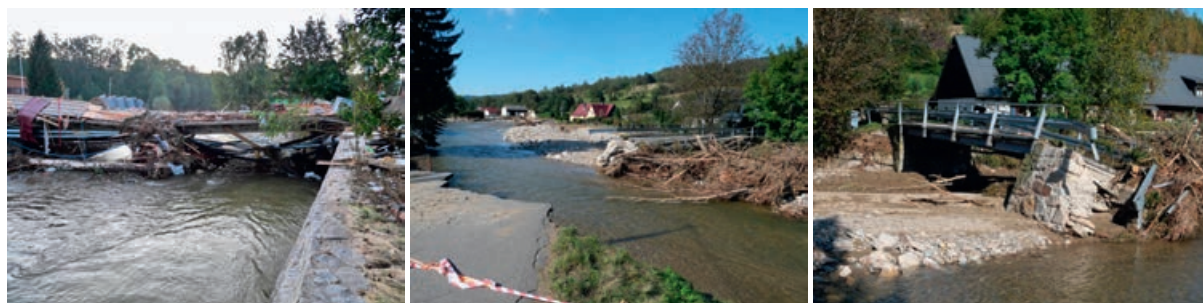
Fot. 1. Skala zniszczeń obiektów mostowych na ziemi kłodzkiej w 2024 r.
