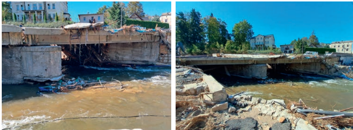
Fot. 7. Awaria mostu belkowego oraz teren sąsiadujący z obiektem w Łądku-Zdroju (stan techniczny z 22 września 2024 r.)
