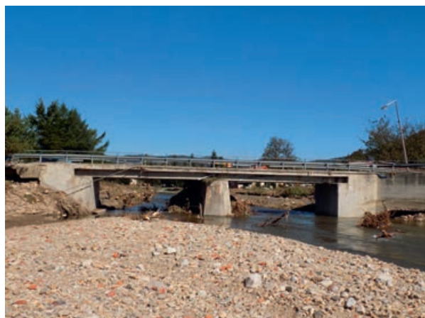
Fot. 8. Żelbetowy most belkowy w Radochowie wraz otaczającym terenem (stan techniczny z 22 września 2024 r.)
